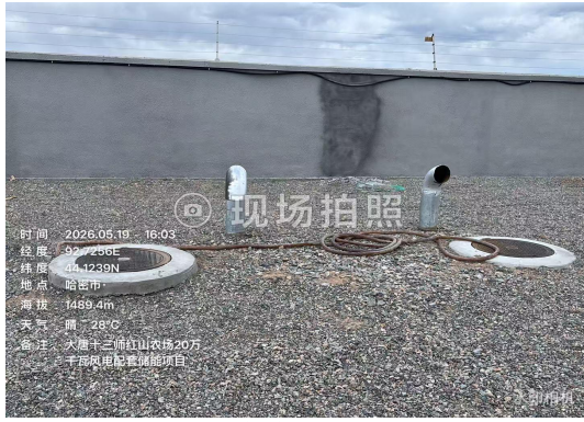
主变事故油池
