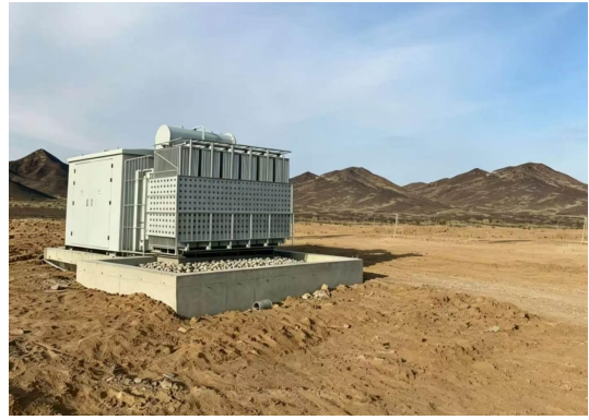
箱式变压器事故油坑
